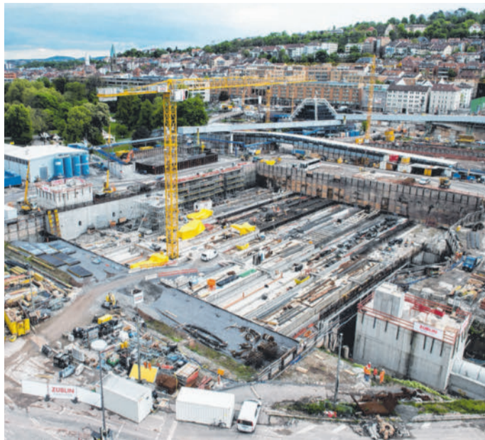
Baustelle mitten in Stuttgart: Das gigantische Bahnprojekt „Stuttgart 21“ sorgte für erbitterte Auseinandersetzungen.
