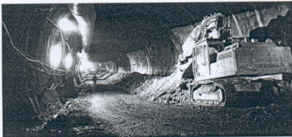
Der Eisenbahn-Tunnelbau in Tirol – im Bild bei der Inntaltrasse – bringt auch Umwegrentabilitäten.
